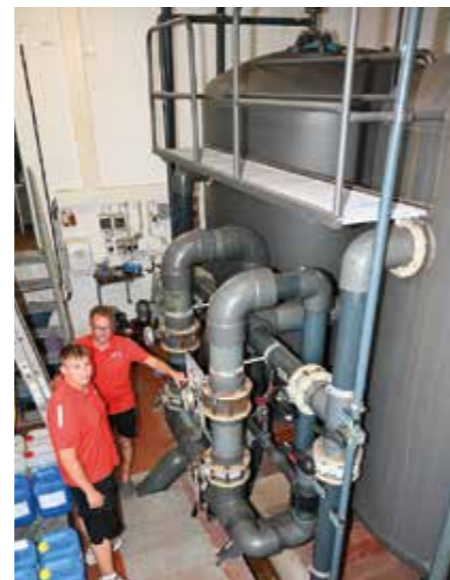
Auch die riesigen Wasserfilter haben die Mitarbeiter der Bäder stets im Blick. Fotos (3): -ul-
